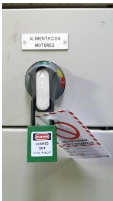
Fig. 5 - FG16 consignado y señalizado.
