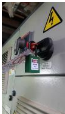
Fig. 6 - FG004 consignado y señalizado
